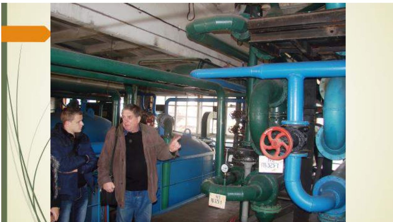
Фото 2. Осмотр принципиально нового теплообменного оборудования котельной.
